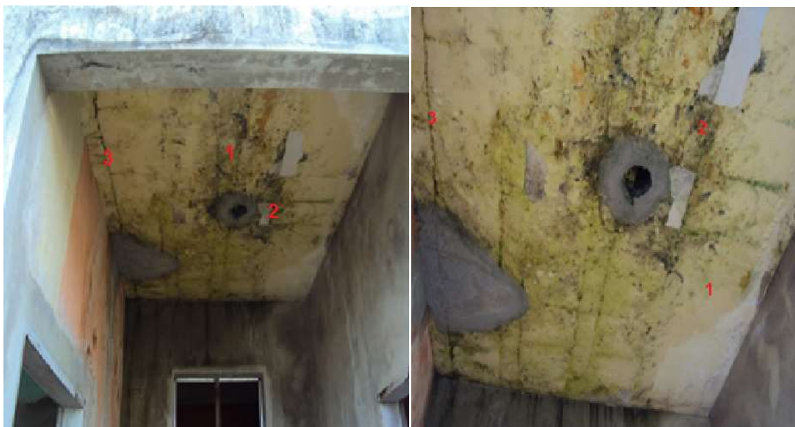
Figura 16 – Laje do banheiro da escola Figura 17 - Laje do banheiro da escola
